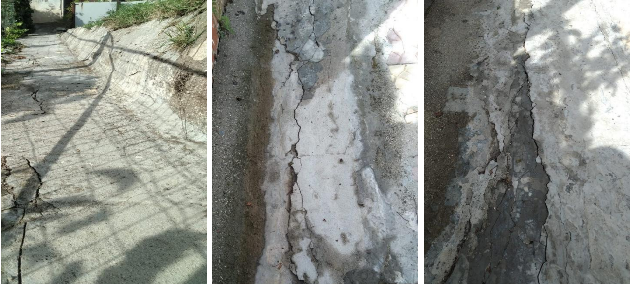
Fessurazioni longitudinali dello scatolare di protezione
