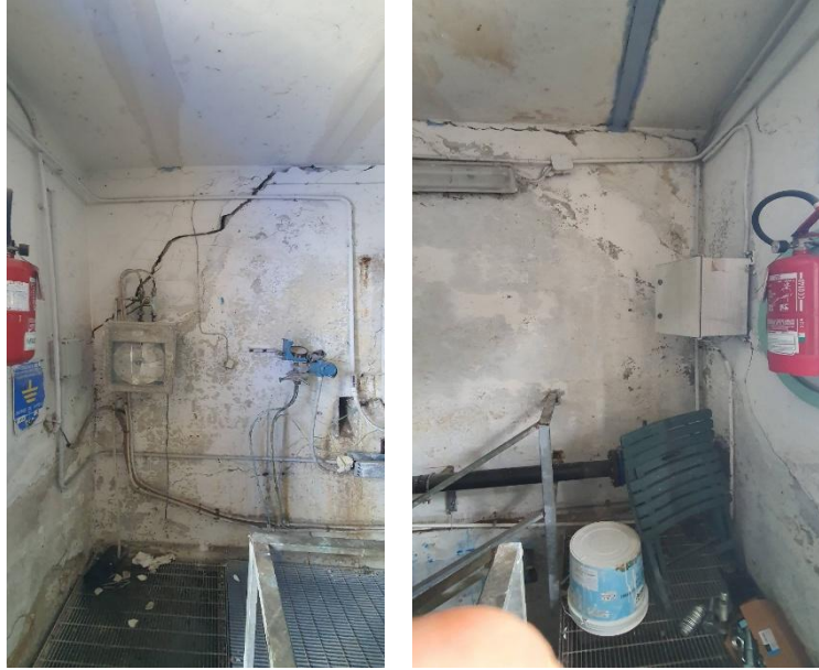
Quadro fessurativo all'interno della struttura
