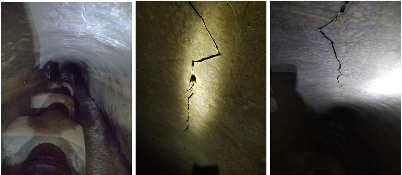
Ingresso della galleria e fessurazioni lungo le pareti
