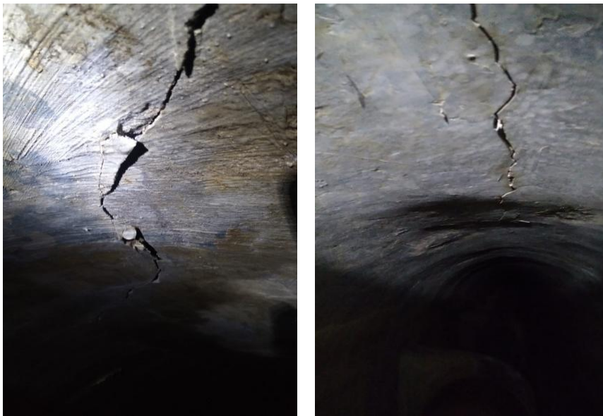
Fessurazioni individuate lungo la volta e le pareti
